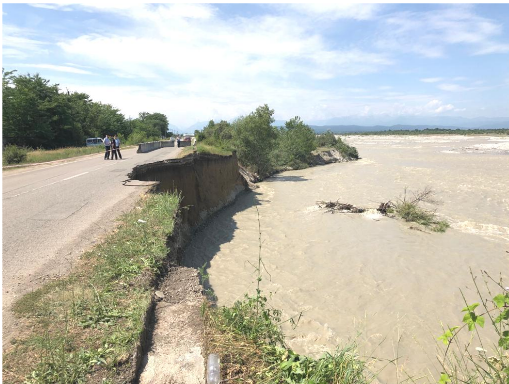
Рисунок 1. Размыв автомобильной дороги вдоль реки Черек Figure 1. Erosion of the highway along the Cherek River
