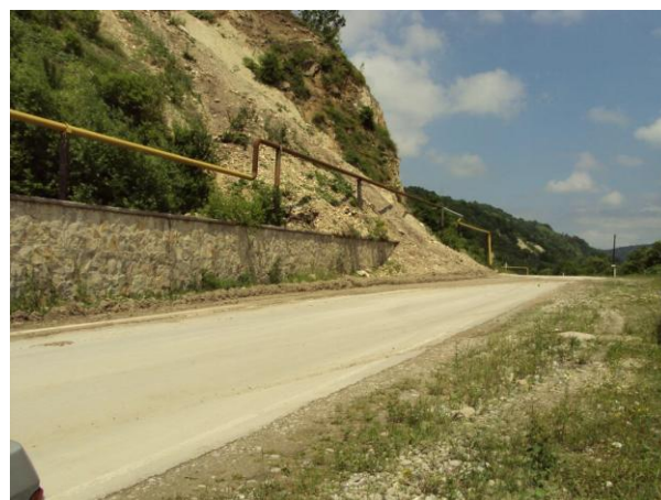
Рисунок 1 – Обрушение откоса по горной дороге в Приэльбрусье КБР
