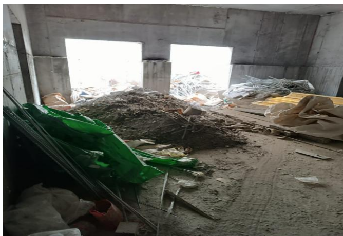
Рисунок 2 – Строительный мусор в период проведения работ
