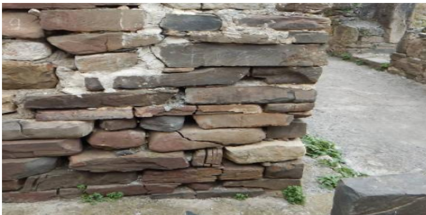
Рисунок 1– Угол северного фасада Тхаба-Ерды с раскрытием трещин до 10 мм
