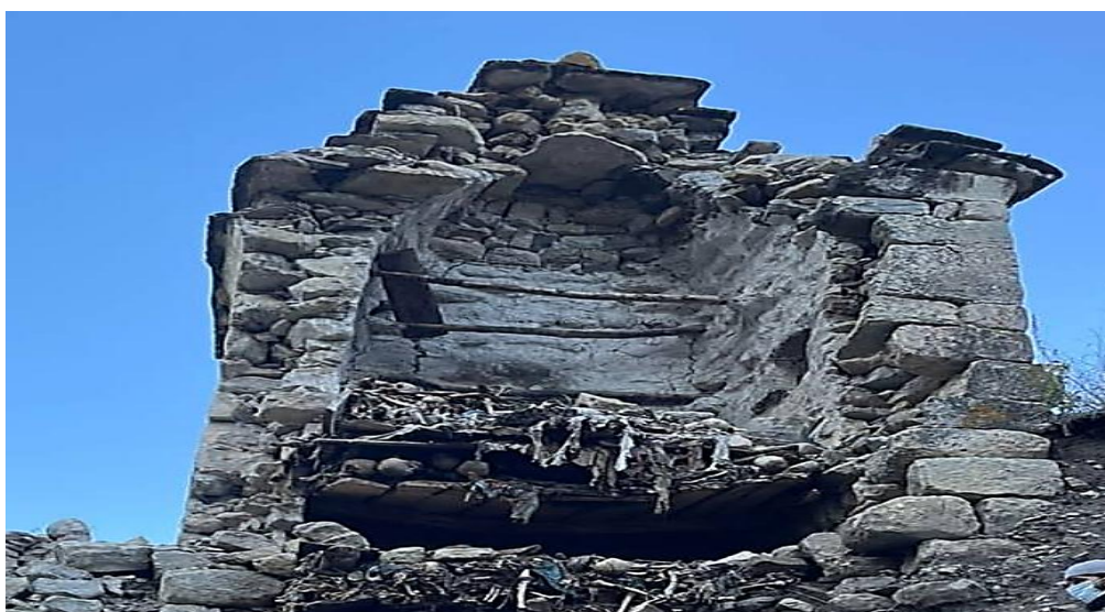
Рисунок 2 – Итог обрушения наземного склепа по причине обвала
