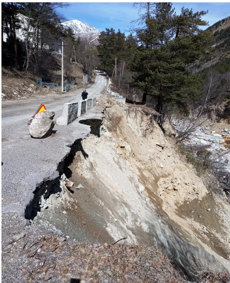
Рисунок 2 – Участок автодороги между мостом через реку Шхельда и а/л «Шхельда» (левый склон ущелья Адылсу) – 11.04.2020 г.
