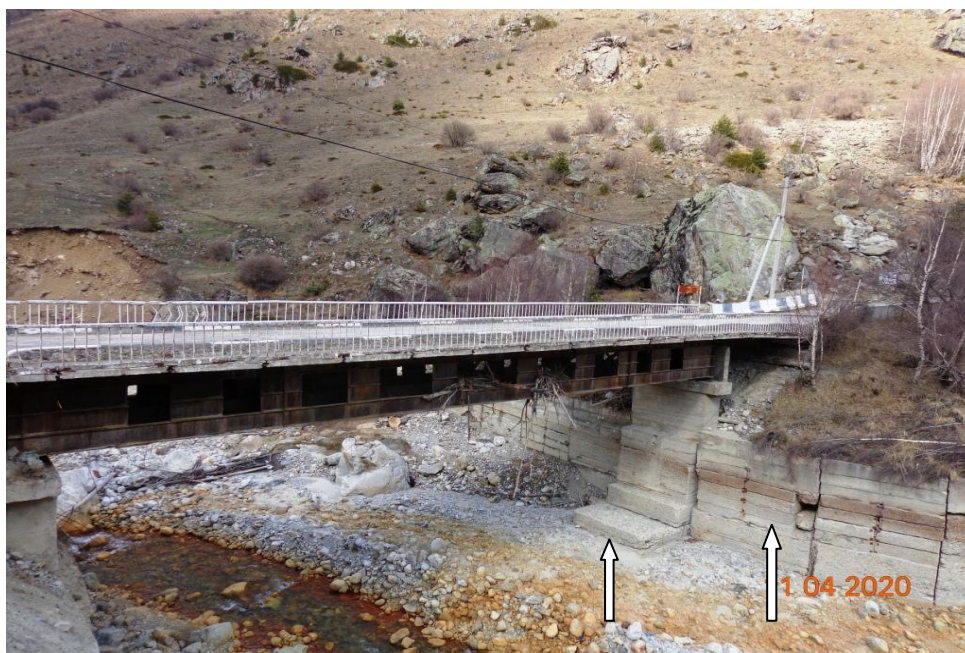
Рисунок 5 – Мост через реку Адыл-су (вид с левого берега). Стрелками показаны места локальных дефектов в бетонных конструкциях
