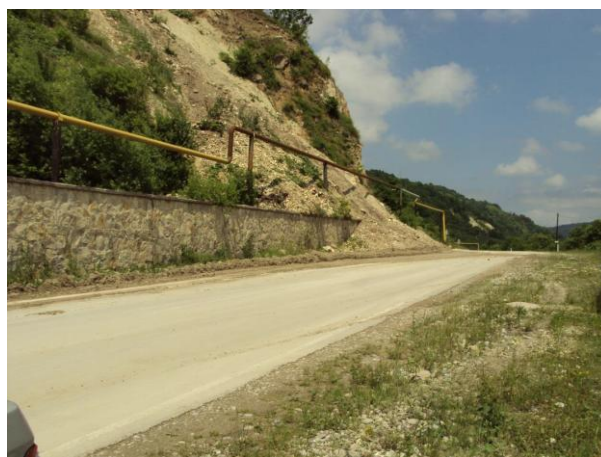
Рисунок 1 – Обрушение откоса по горной дороге в Приэльбрусье КБР
