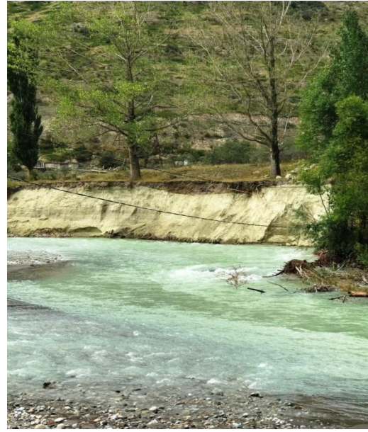
Рисунок 4 – Участок подмыва (размыва) откоса дамбы хвостохранилища №1 с обнажением тела складированных здесь отходов обогатительной фабрики ТВМК
