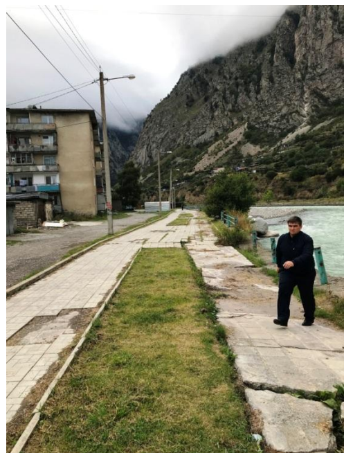
Рисунок 8 – Место повреждения (деформации) правобережной защитной бетонной стены и участка набережной реки Баксан с пешеходной дорожкой
