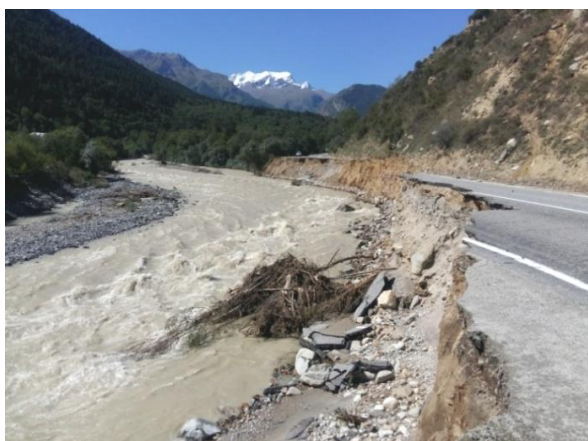
Рисунок 1 – Размыв берега и полотна автодороги паводком р. Баксан (фото ФГБУ «ВГИ»)
