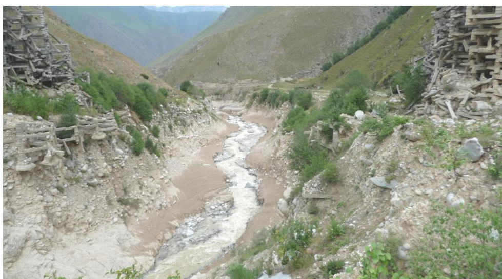
Рисунок 2 – Русло р. Герхожан-Су в районе разрушенной плотины, где образовался проран
